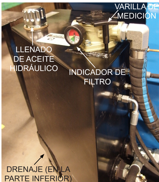
Conjunto del depósito hidráulico
